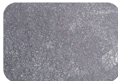
belijning slecht zichtbaar en vervuilde toplaag
