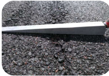
gerepareerde scheur, onvlak en ruw
