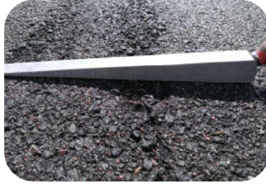
gerepareerde scheur, onvlak en ruw
