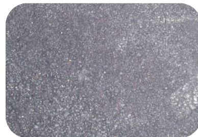
belijning slecht zichtbaar en vervuilde toplaag
