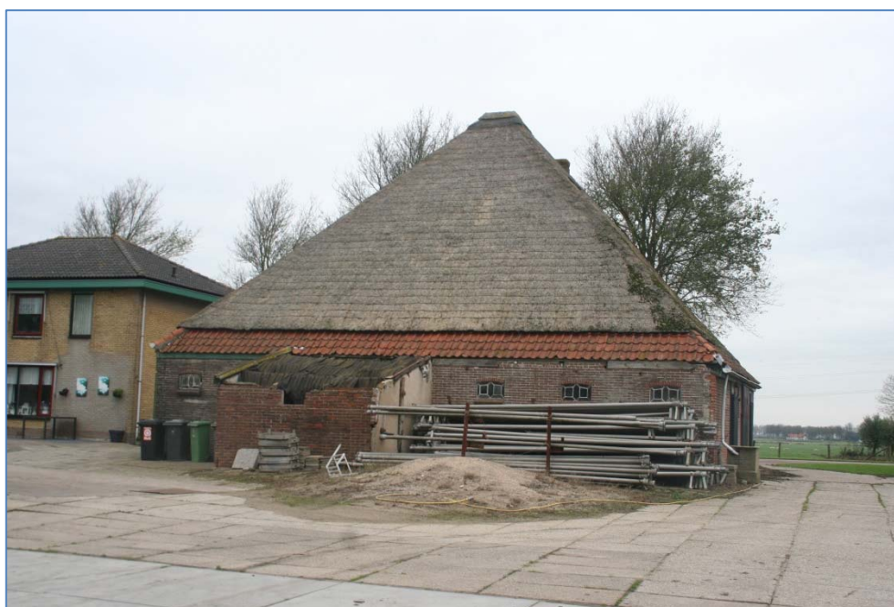
Onderdeel van het plangebied is een zwaar vervallen stolpboerderij die gesloopt zal worden.
