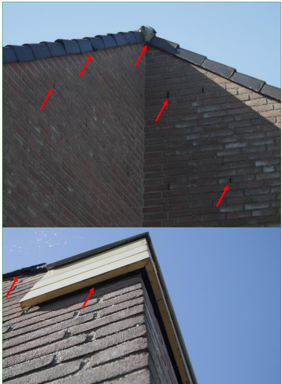
Gaten onder dakpannen, spouwgaten en spleten onder de boeidelen (voorbeelden aangegeven met rode pijlen) geven mogelijk toegang tot voor vleermuis geschikte achterliggende ruimtes.
