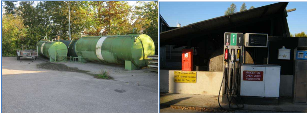
Figuur 5: Opslag mobiele brandstoftanks en brandstofinstallatie
