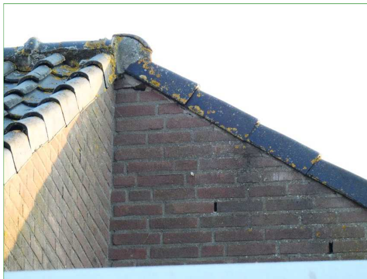
Gaten in metselwerk en overhangende dakpannen op ruw metselwerk leveren broedgelegenheid buiten het plangebied.
