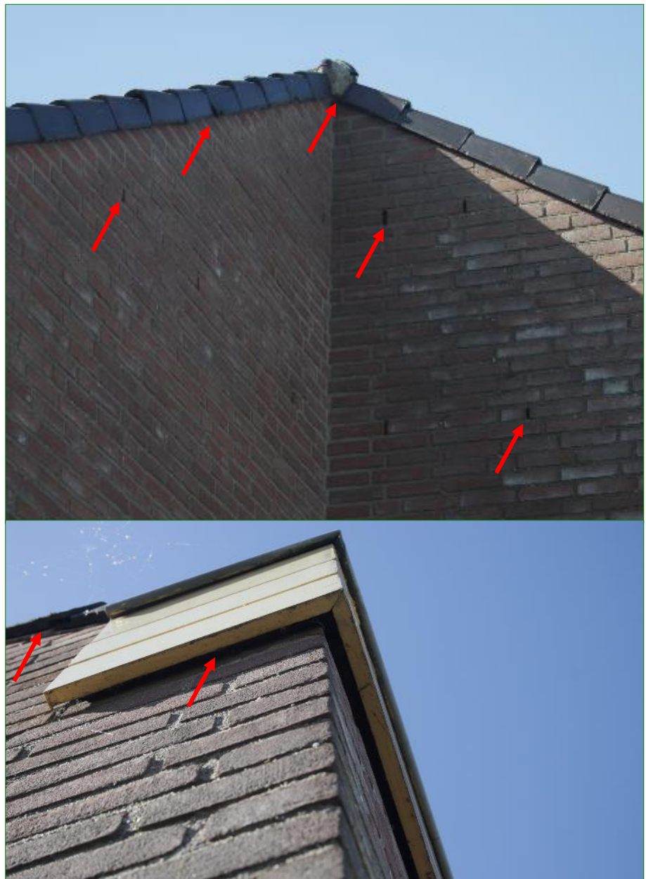
Gaten onder dakpannen, spouwgaten en spleten onder de boeidelen (voorbeelden aangegeven met rode pijlen) geven mogelijk toegang tot voor vleermuis geschikte achterliggende ruimtes.
