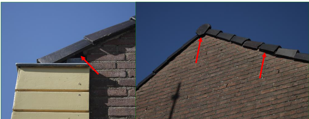
Ruimtes onder dakpannen (rode pijlen) kunnen toegang geven tot voor Huismus en Gierzwaluw geschikte nestplaatsen.
